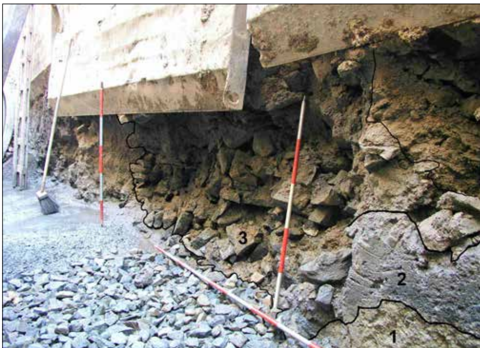
Obr. 3. Severovýchodní profil výkopu s destrukcí (3) patrnou pod pažením. Zcela na okraji snímku vrstvy 1 a 2. Foto D. Menoušková.
