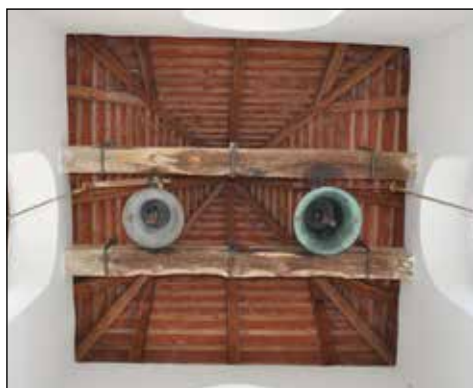
Závěs zvonů ve zvonici v Kudlovicích, 2018. Foto J. Káčer. Fotoarchiv SM UH.
