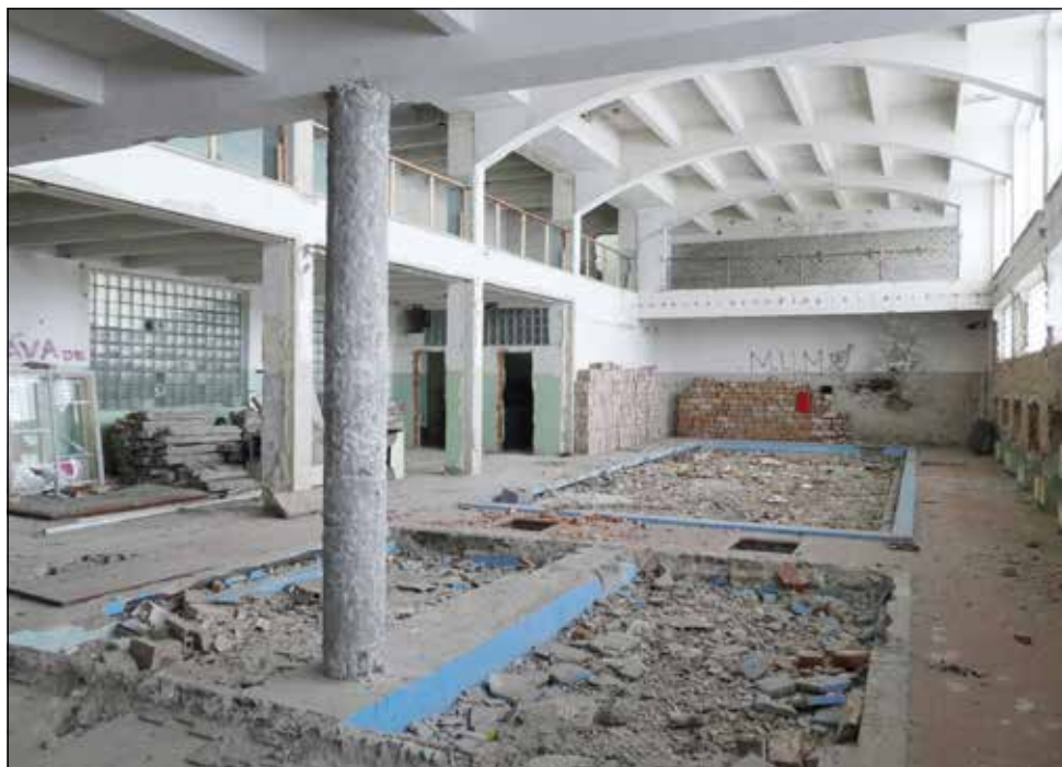
Vanová hala devastovaná vybouranými příčkami a bazény využité jako skladiště suti, 2018. Foto V. Říhová.
