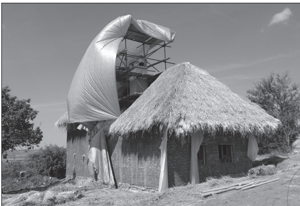
Kopie objektu z Veletin čp. 25 – objekt ve fázi realizace doškové střešky a dokončování výstavby komínové hlavy v srpnu 2015. Foto J. Blahůšek.
