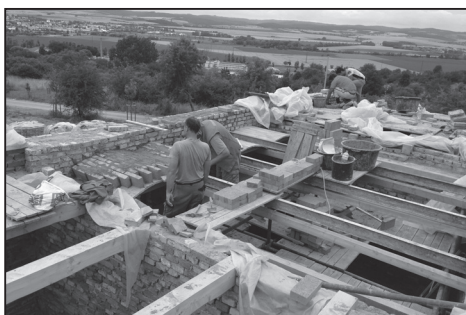
Výstavba kopie objektu z Boršic čp. 288 – stropní klenby nad chlévem, 2015. Foto J. Blahůšek.
