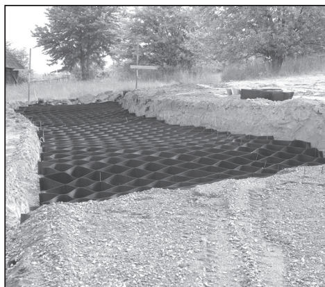
Podkladní konstrukce pro sypané cesty v areálu MVP Rochus. Foto J. Káčer, fotoarchiv Parku Rochus, o.p.s., 2015.
