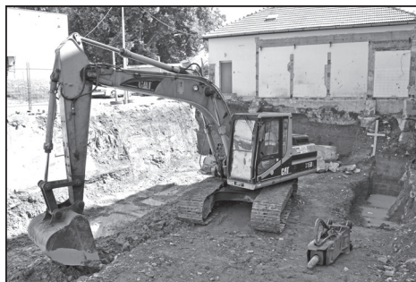
Obr. 3. Pohled na stavební jámu od jihozápadu ve fázi bagrování. Foto J. Bartík.
