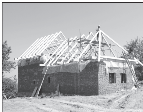
Stavba krovu nad objektem z Veletin. Foto J. Káčer, fotoarchiv Parku Rochus, o.p.s., 2015.
