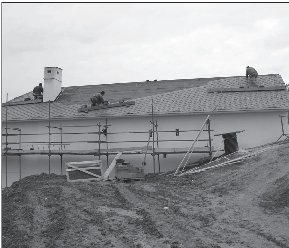
Pokryvání střechy břidlicí na nadsklepním domem z Tučap. Foto J. Káčer, fotoarchiv Parku Rochus, o.p.s., 2015.
