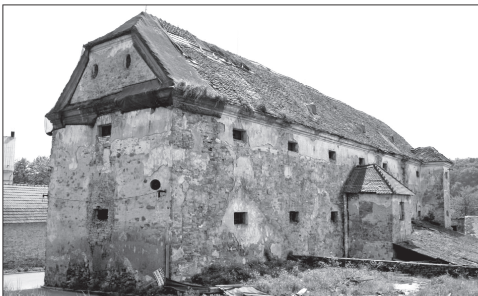
Pohled na objekt z roku 2011 od severozápadu znázorňuje mj. špatný stav střechy. Převzato z: Záhorka, Jindřich, Patrný, Michal a Hodeček, Dalibor. Standardní stavebně-historický průzkum bývalého zámku v Louce u Ostrohu . Červenec 2011, titulní strana.
