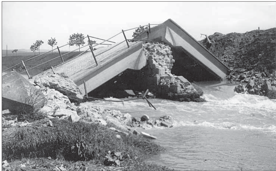
Šumický most po přechodu fronty.
