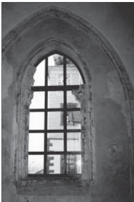
15. Hrad Buchlov – západní okno hradní kaple, vzadu renesanční tzv. Hodinová věž. Foto J. Kohoutek.
