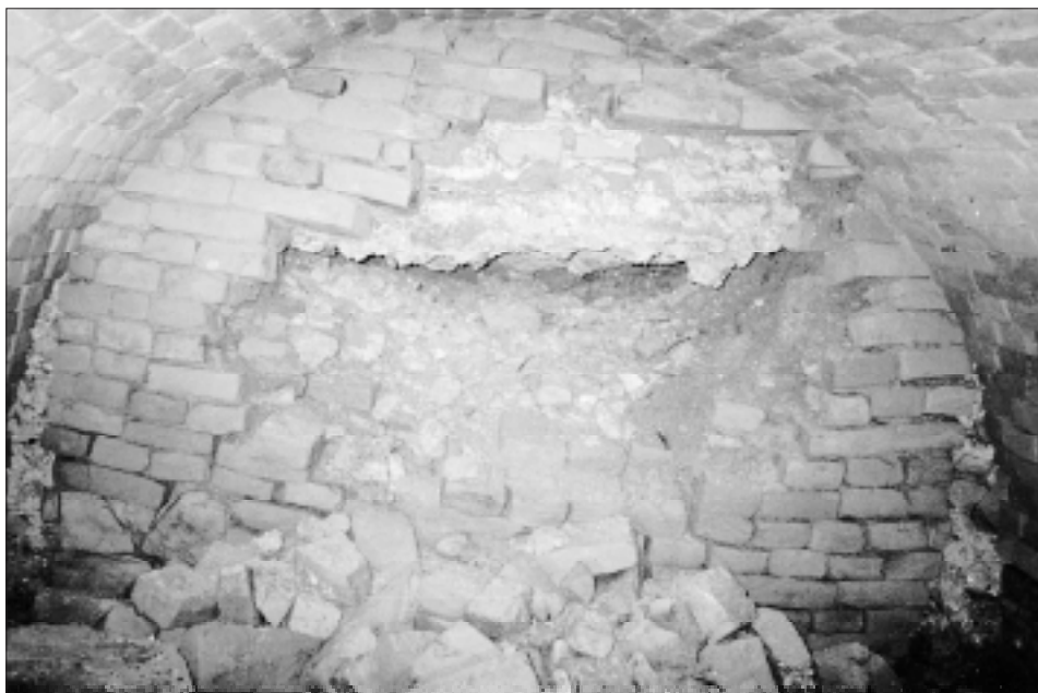
13. Kostel Zvěstování Panny Marie – poškozená východní stěna krypty 3.
