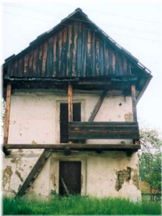
Patrová komora s pavláčkou u čp. 19, čeká na obnovu
