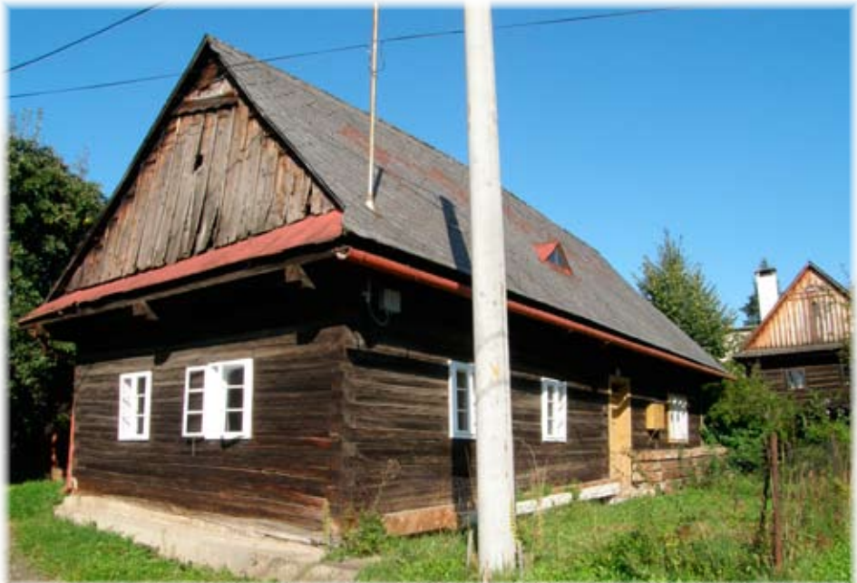
Roubená usedlost čp. 10 s nevhodně umístěným sloupem el. vedení
