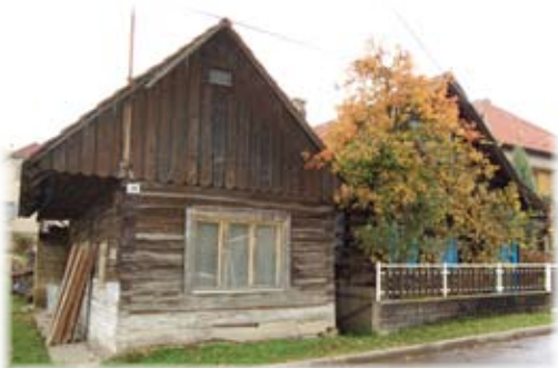
Památkově chráněné roubené stavení čp. 38 se nachází v havarijním stavu
