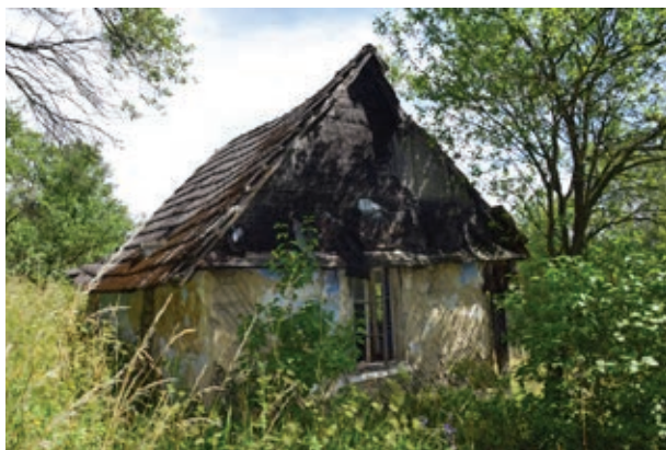
Rozpadající se roubená chalupa čp. 36
