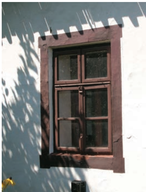
Detail okna s profilacemi a barevným orámováním ve štítové části usedlosti čp. 9
