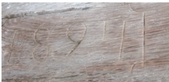
Vročení na venkovním trámu hospodářského traktu u čp. 30
