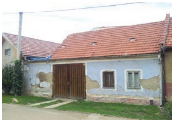
U stavení čp.83 dochovaná zdobnost fasády volá po citlivé obnově
