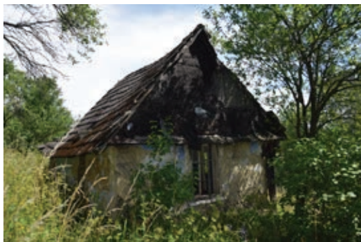
Rozpadající se roubená chalupa čp. 36
