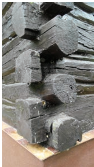
Detail roubení čp. 41, nepříliš vhodně upravené silnou vrstvou lakovaného nátěru
