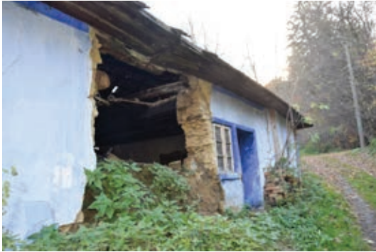
Detail destruovaného domu čp. 29, stav v roce 2014
