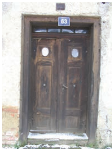
Detail původních vstupních kazetových dveří čp. 63
