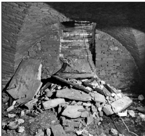
Obr. 6. Krypta – B na evangelní straně kostela sv. Františka Xaverského s rozbitou vstupní stélou. Fotoarchiv Slovákckého muzea v Uherském Hradišti. Foto L. Chvalkovský.
