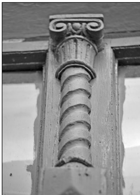
Detail rámu zdoběného do tvaru tordovaného sloupku zakončeného zdobnou hlavicí, usedlost čp. 33, Zdislavice.
