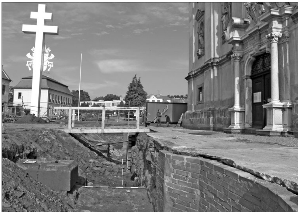
Obr. 1. Celkový pohled na odkryté situace v hydroizolačním výkopu před západním průčelím baziliky, Velehrad 2009. Foto Z. Schenk.
