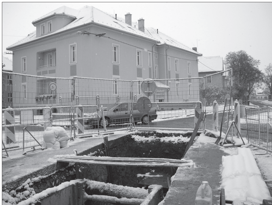
3. Pohled od jihu na začátek výzkumu v křižovatce ulic Dlouhé, Jana Lucemburského a Otakarovy. Foto D. Menoušková.
