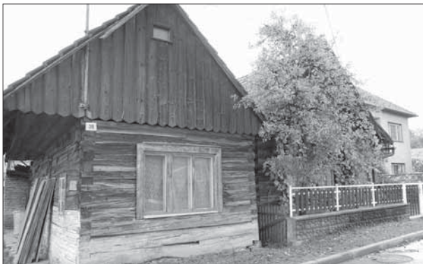
Nedašova Lhota, památkově chráněná usedlost čp. 38 ve velmi špatném stavebně technickém stavu.
