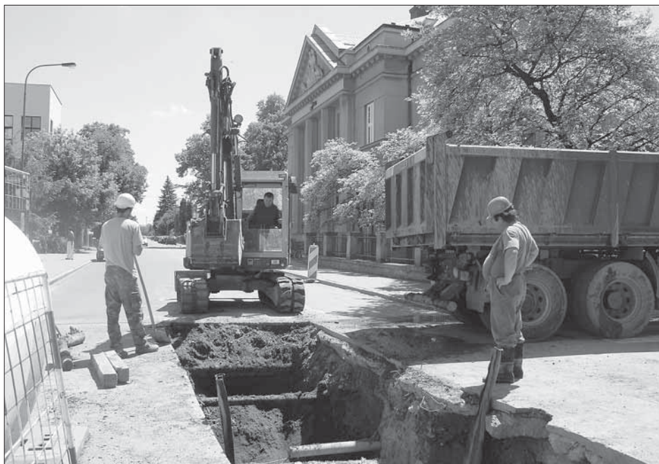
10. Uherské Hradiště, oprava kanalizační stoky „V“, druhá etapa 2007, křižovatka Svatováclavská–Kollárova ul., výkopové práce v prostoru barokního bastionu sv. Josefa. Pohled od severu. Foto D. Menoušková.
