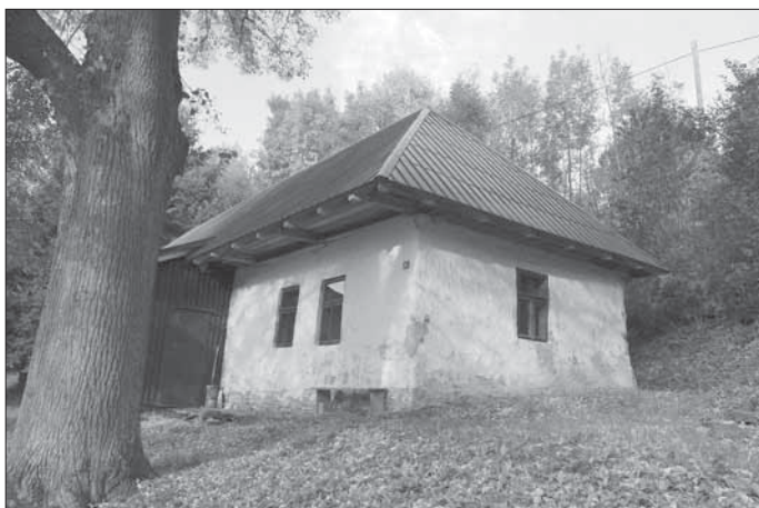
Usedlost čp. 28 – z nabíjanice . Příklad nevhodně opravené střechy. Vápenice 2007.
