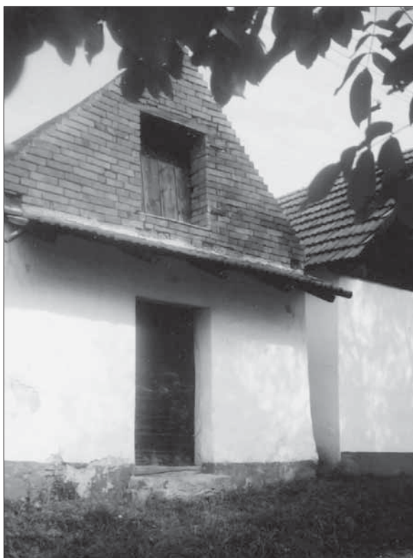
9. Búda č.p. 13 čeká na záchranu a celkovou obnovu. Vlčnov.
